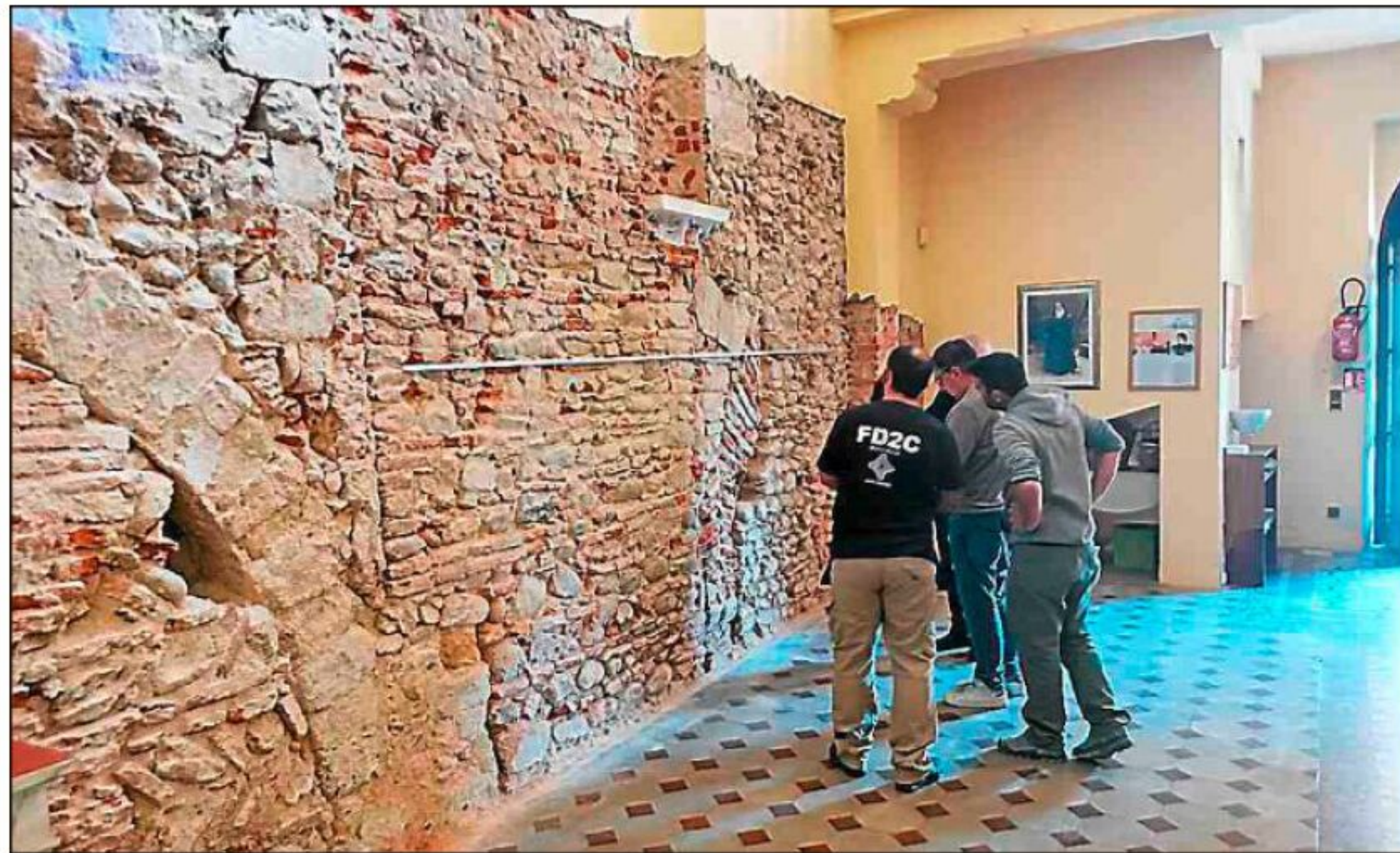
L'intervention en cours vise à remettre en état le mur et les parements.
